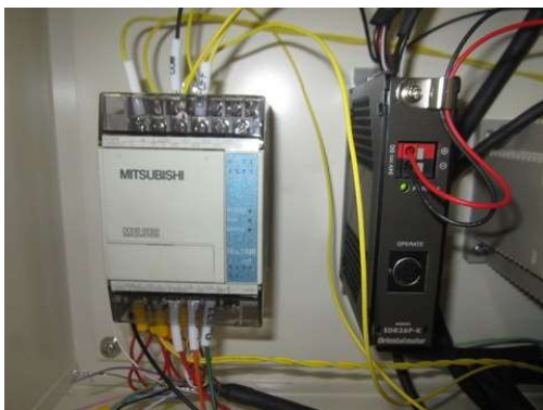
プログラムロジックコントローラ(PLC)
